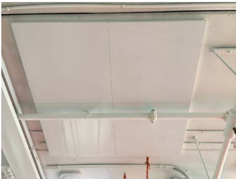
Fot. 6. Dobra praktyka: Adaptacja sufitu i integracji z instalacjami technicznymi w funkcjonującym biurze
