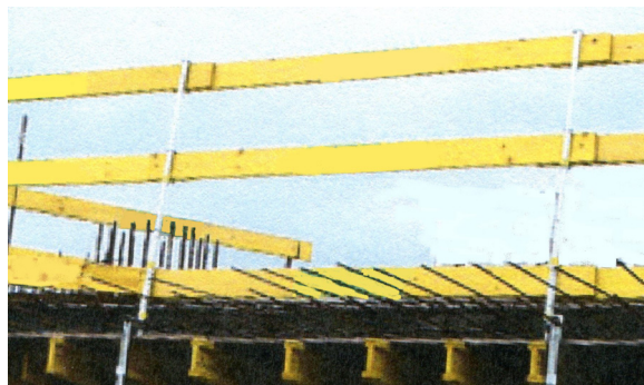
Rys. 4. Balustrada ochronna na krawędzi stropu
