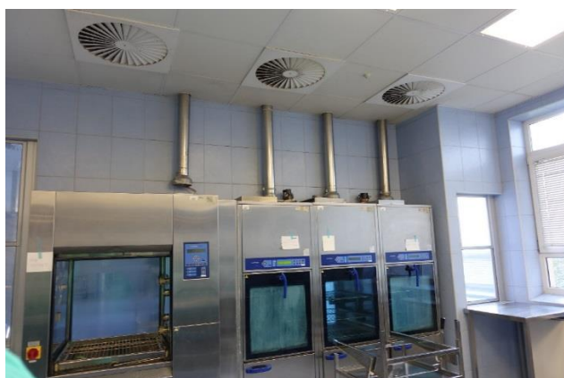
Rys.5.40. Ogólny widok fragmentu pomieszczenia sterylizacji – strefy czystej oraz oprawy oświetleniowej
