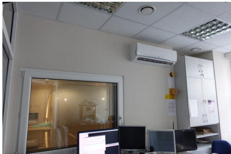
Rys. 5.10 Widok opraw oświetleniowych w pomieszczeniu obsługi rezonansu magnetycznego – 3Tesle.
