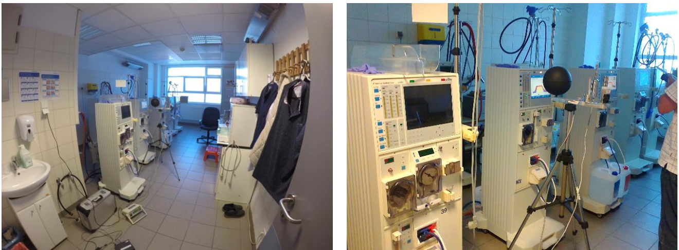
Rys. 5.70. Stacja Uzdatniania Wody (do dializ).
