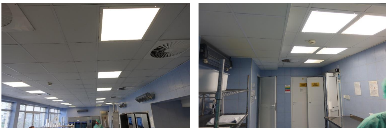
Rys.5.36. Widok pomieszczenia Centralnej sterylizacji – strefy brudnej oraz opraw oświetleniowych
