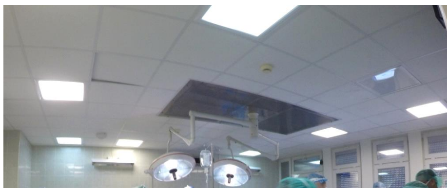
Rys. 5.33. Widok opraw oświetleniowych w sali operacyjnej
