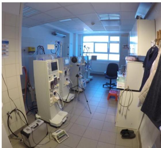
Rys. 5.9 Pomieszczenie stacji uzdatniania wody.
