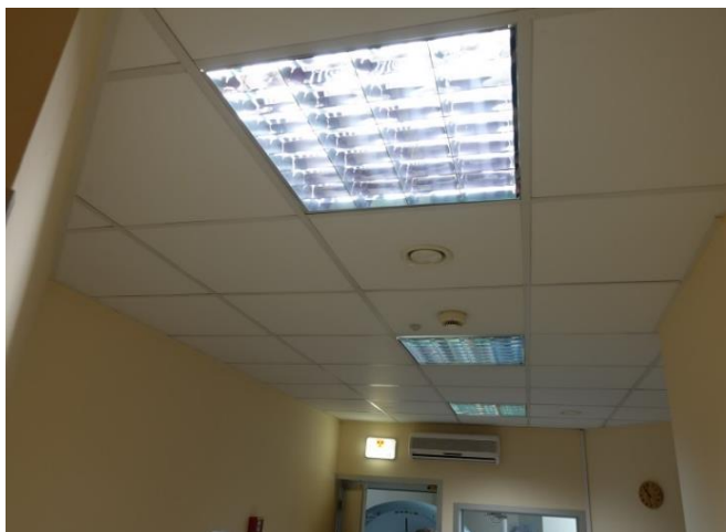
Rys. 5.21. Widok opraw oświetleniowych w pomieszczeniu obsługi tomografu 64 CT
