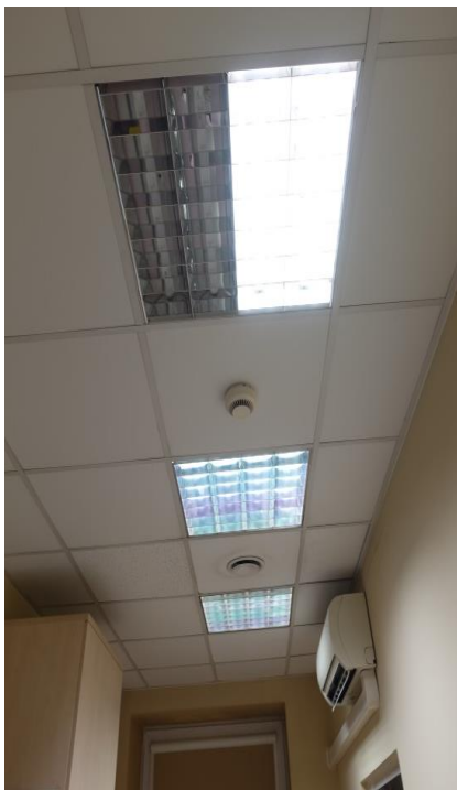
Rys. 5.13. Widok opraw oświetleniowych w pomieszczeniu obsługi rezonansu magnetycznego 1,5Tesli .
