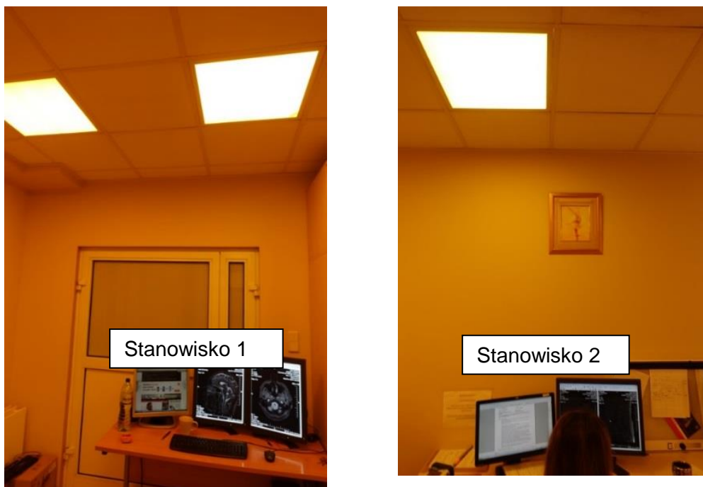
Rys. 5.25. Widok opraw oświetleniowych i stanowisk pracy
