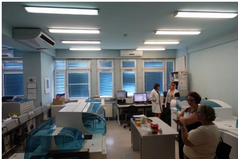
Rys. 5.59. Widok opraw oświetleniowych pomieszczeniu laboratorium
