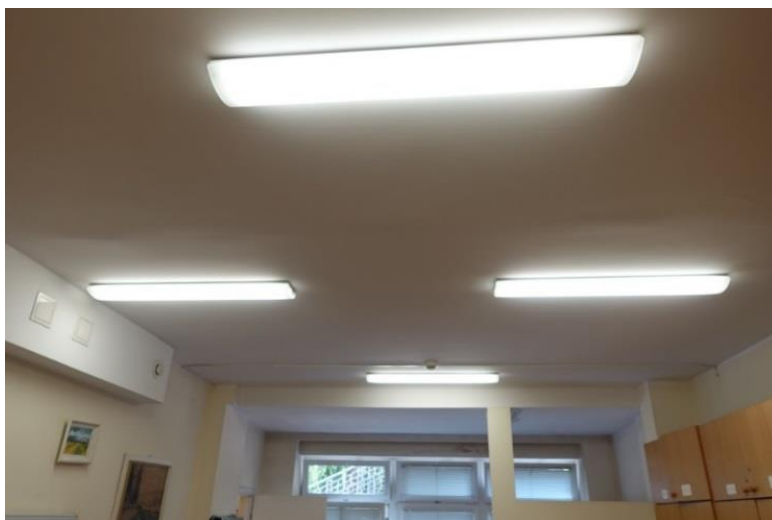
Rys.5.29. Widok opraw oświetleniowych
